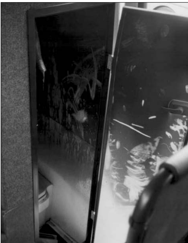
Bild 2.5: Geöffnete Toilettür mit Rußantragungen
