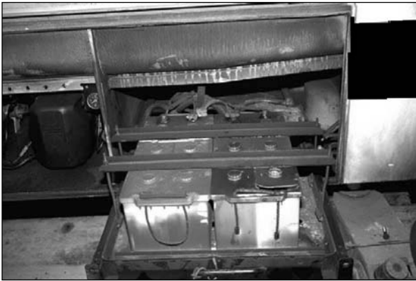
Bild 10.5: Brandgeschädigte Batterien auf einem Auszug
