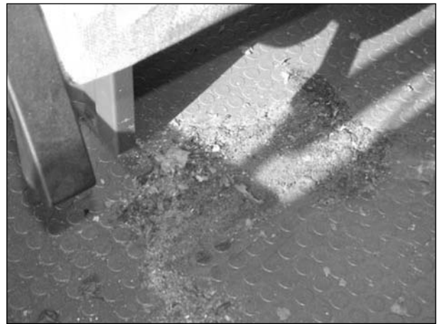
Bild 12.15: Abgebrannter Fußbodenbelag nach Beseitigen der Papierreste
