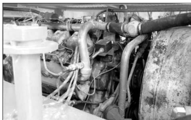
Bild 10.1: In Großmaschine eingebauter Thermofühler und Löschdüsen [90]
