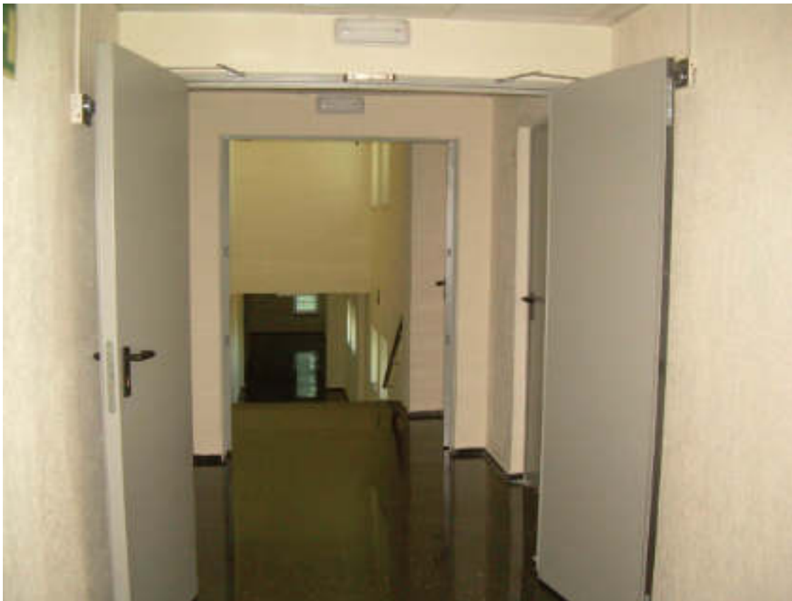
Puerta cortafuego con retenedores para mantenerla permanentemente abierta y cierre automático
